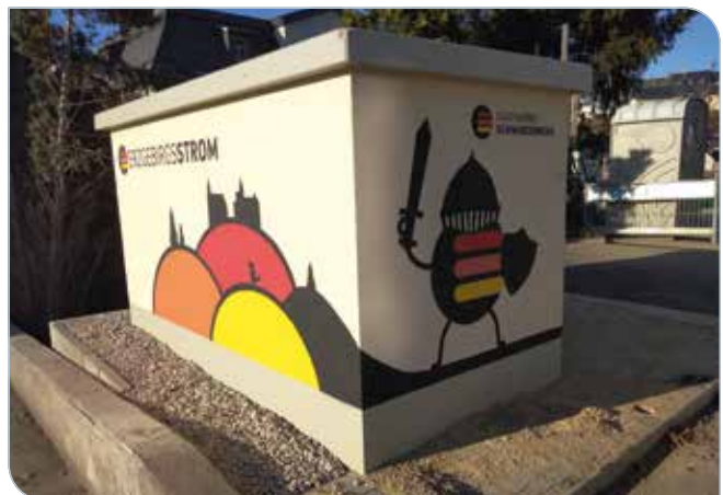
Unsere neue Trafostation im Bereich Herrenmühle.
