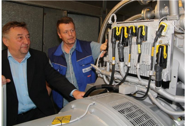
6 Stadtwerke-Chef und Monteur inspizieren das neue BHKW-Modul
